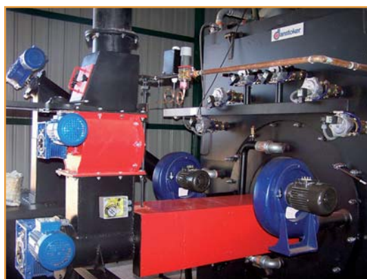
Caldera de Biomasa
