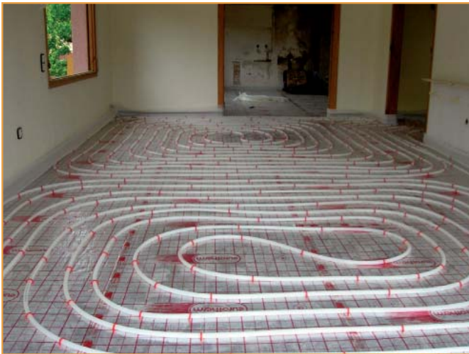
Instalación geotérmica y aplicación en suelo radiante
