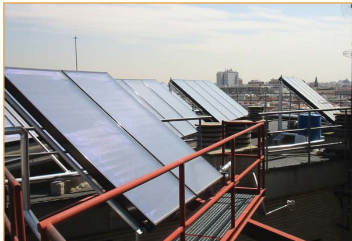
Instalación solar térmica para ACS
