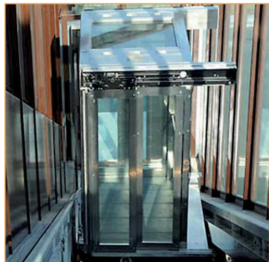
Ascensor de última generación
