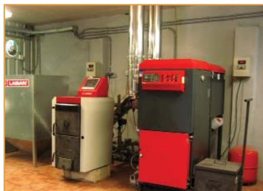
Calderas de baja temperatura
